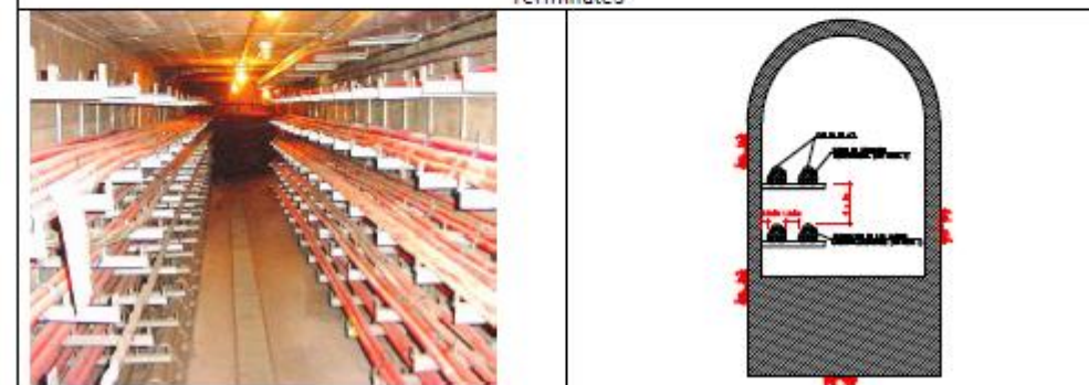
Cables en galería visitable
